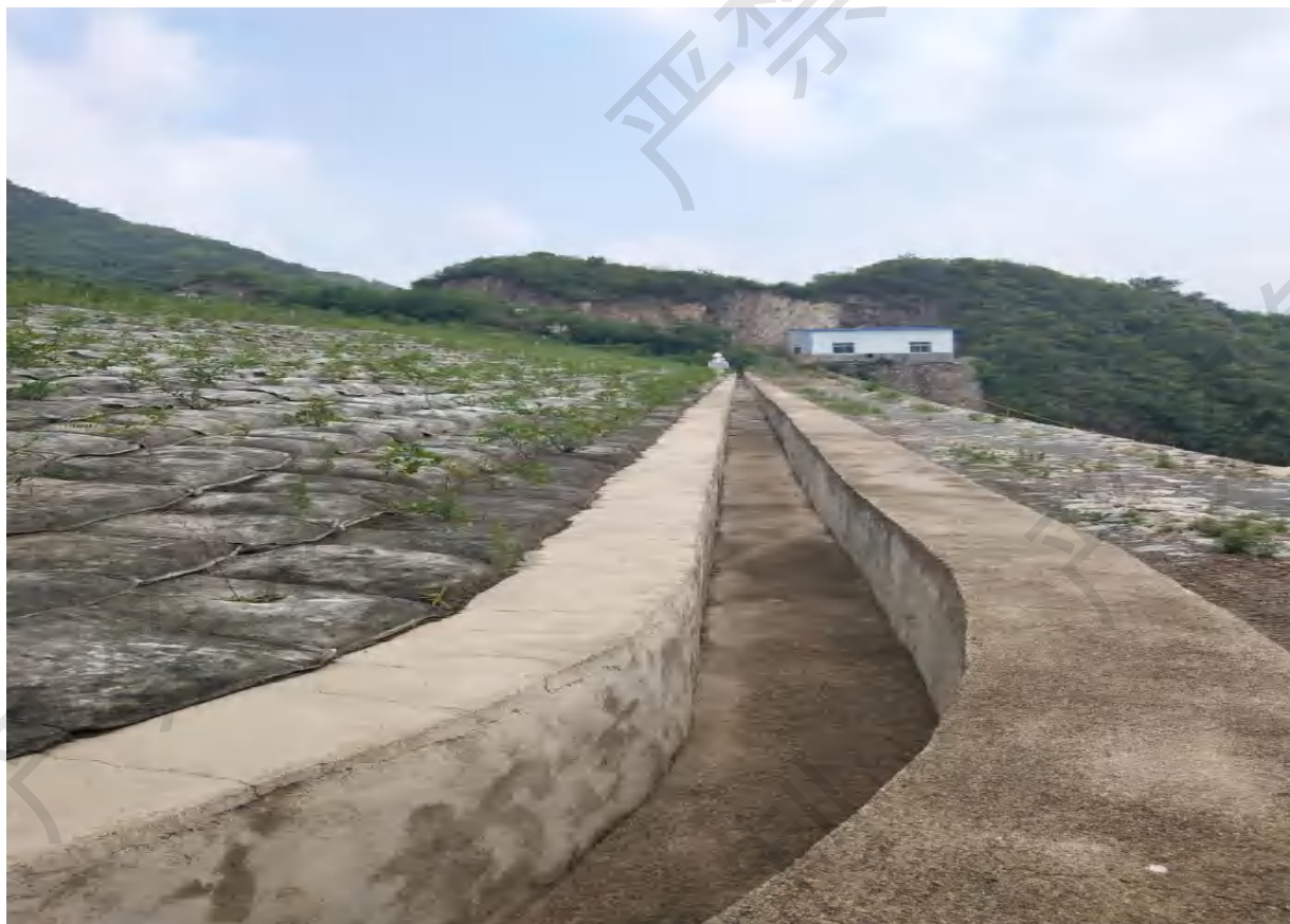
图 2.4-5 坝面纵向排水沟
