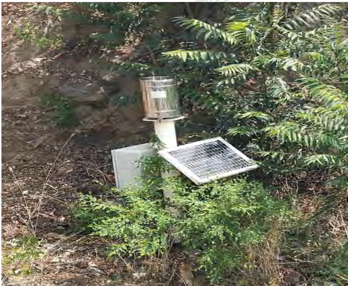
图 2.4-14 在线降雨量监测设施
