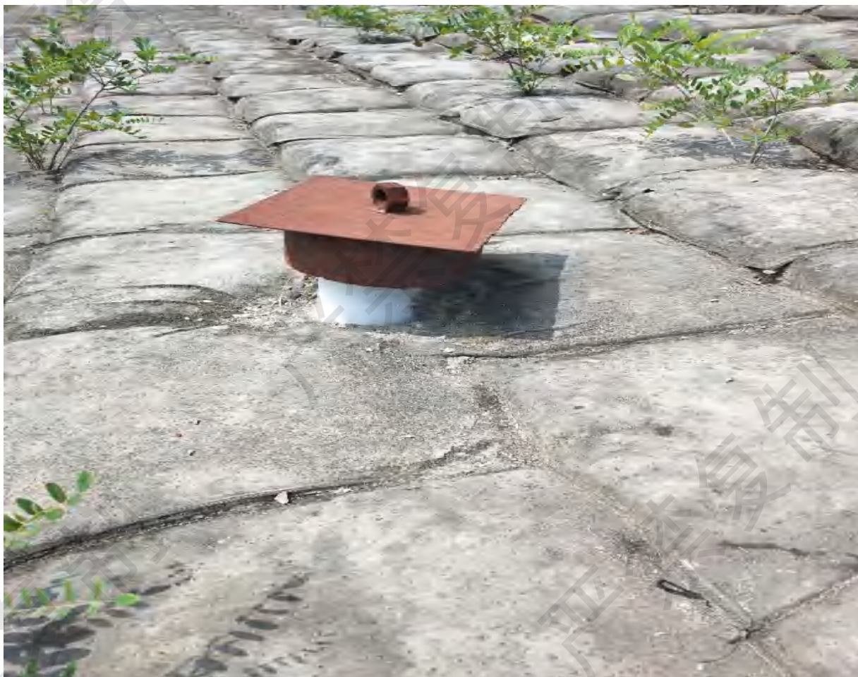
图 2.4-10 人工浸润线观测设施
